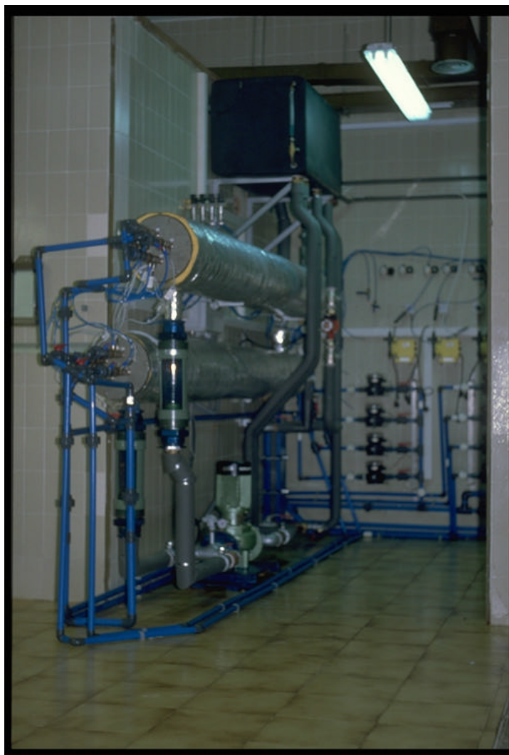
Figura IV.1. Vista general de los intercambiadores de calor-condensadores objeto de estudio.
