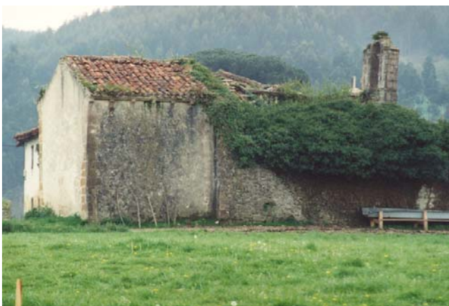
Ruinas de la capilla aneja al hospital de San Lázaro en Abaño.
