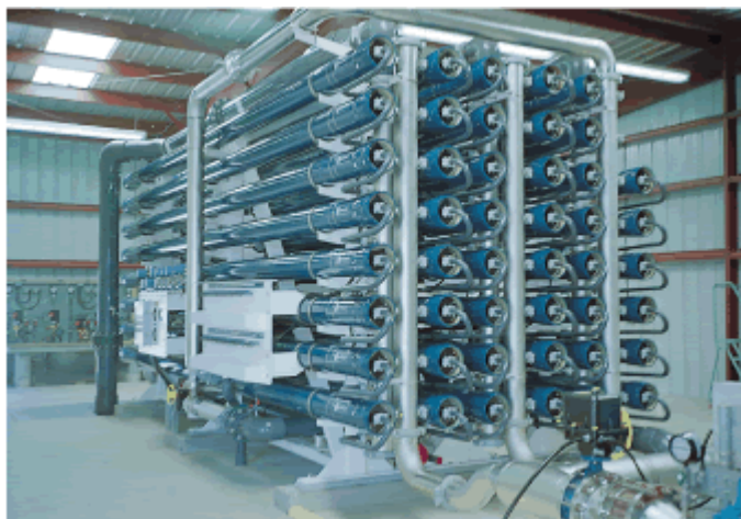
Figura 11.1. Instalación de ósmosis inversa, de 19000 m 3 /día, de agua para la industria, a partir de aguas residuales, en Carson, California
