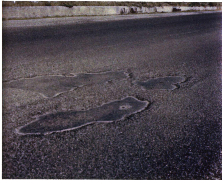
FIGURA 3.26. Fallo por disgregación.
