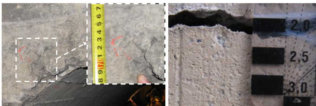
Figura A2.2.- a) Situación en altura de una fisura; b) Medición ancho de fisura
