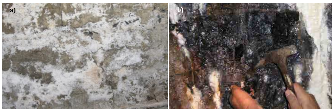
Figura A2.1.- a) Eflorescencias zona galerías; b) Técnico tomando muestra en un estribo
