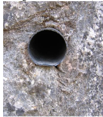
Agujero de drenaje de plástico (Mallorca)
