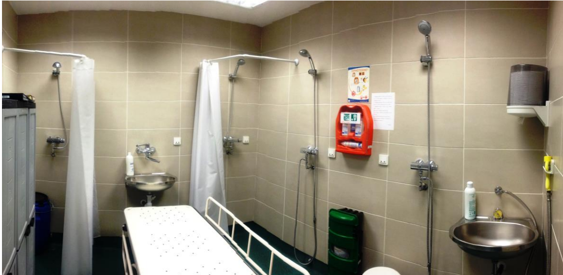
Figura 11.- Área de Descontaminación Química en el Servicio de Urgencias del Hospital Clínic de Barcelona. Se observan 4 duchas para la descontaminación con agua o agua y jabón. A la derecha se observa también el lavajos para la descontaminación ocular con agua. Entre dos de las duchas se observan dos murales (naranja y verde) con diversos preparados de Diphotérine® para neutralizar productos corrosivos.
