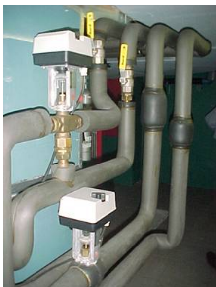
Imatge 8.5 – Connexió a climatitzadors
