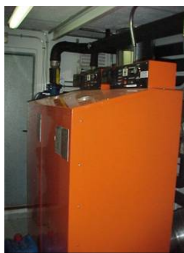
Imatge 8.4 – Caldera de gas natural
