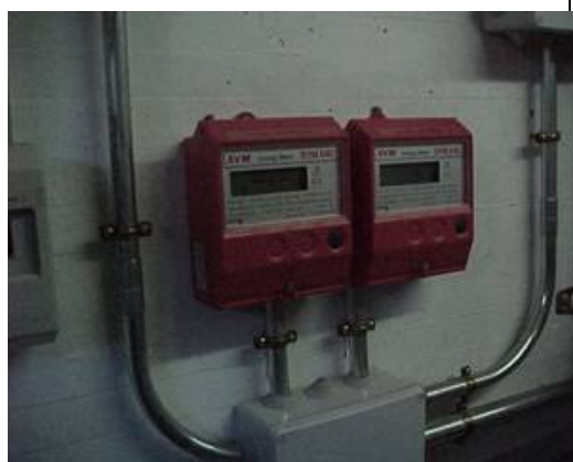
Imatge 8.2 – Comptadors d'energia
