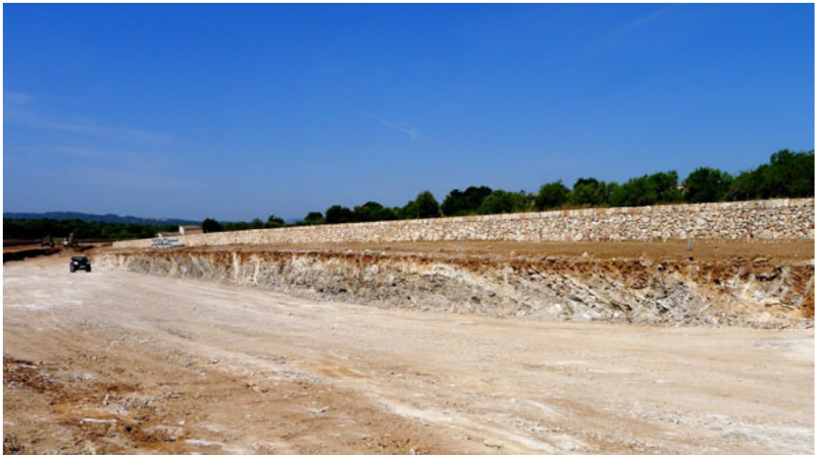
Fig. 6.4.1.8 - Vista general de les obres de la variant de Llubí al juny de 2011 on es pot apreciar la deformació local de la unitat de Calcàries de Santanyi-CCT força alterada (fàcies Pont d'Inca).
