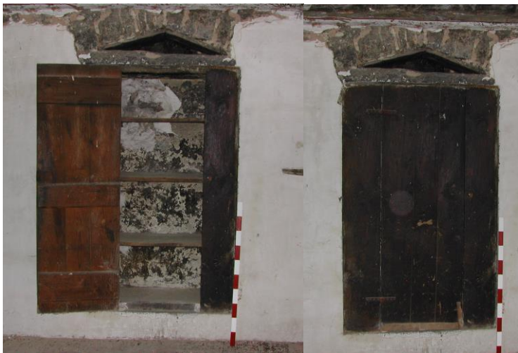
Imatge 133: Armaris encastats.
