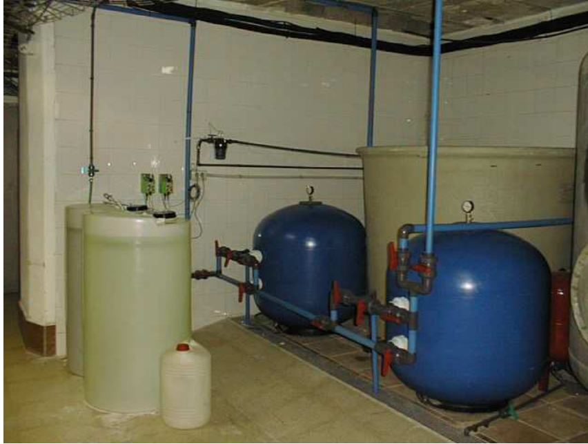
Figura 1.11. Vista general de algunos elementos del sistema de reutilización. El depósito de recirculación, los filtros de arena, los bidones y los dosificadores de hipoclorito de sodio. También se aprecia el color azul que distingue las tuberías que conducen agua gris de las que conducen agua potable, de color negro.
