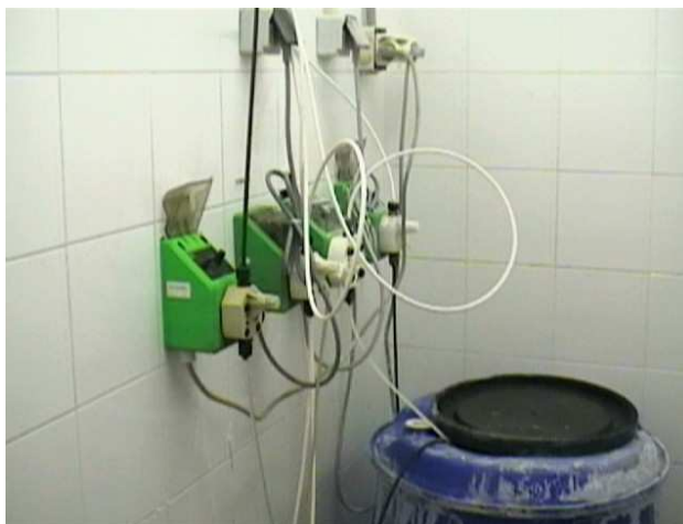
Figura 1.15. El dosificador y el bidón de hipoclorito de la segunda cloración.
