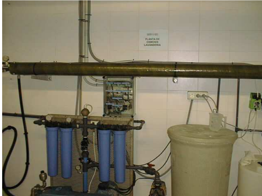
Figura 1.14. Planta de ósmosis inversa del hotel.
