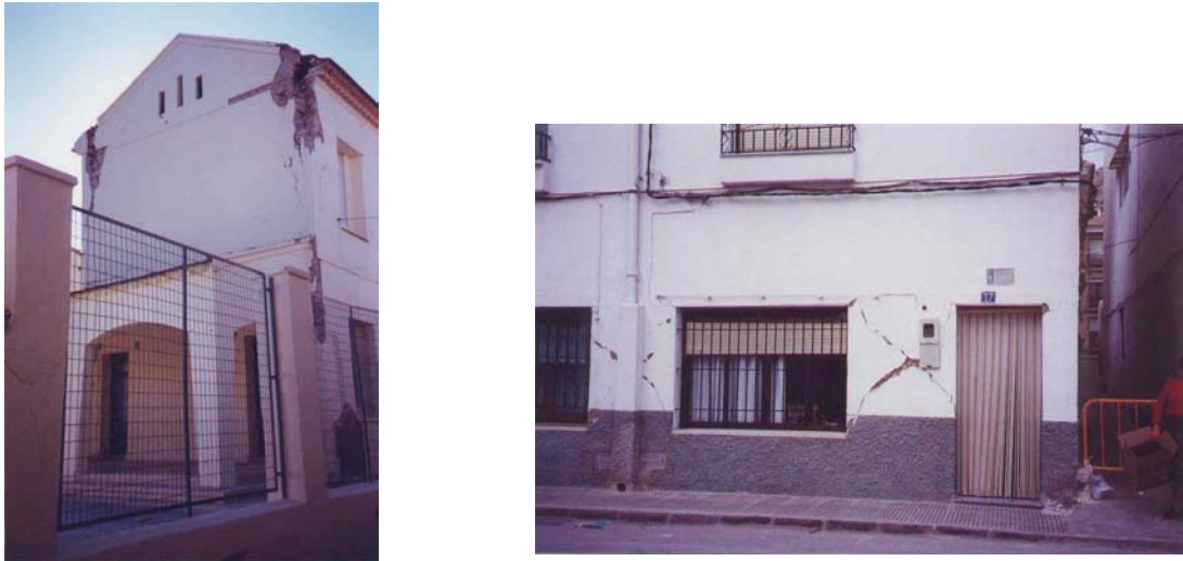
Figura 3.8. Construcciones de mampostería no reforzada dañadas en la población de la Puebla de Mula debidas al terremoto del 2 de Febrero de 1999.
