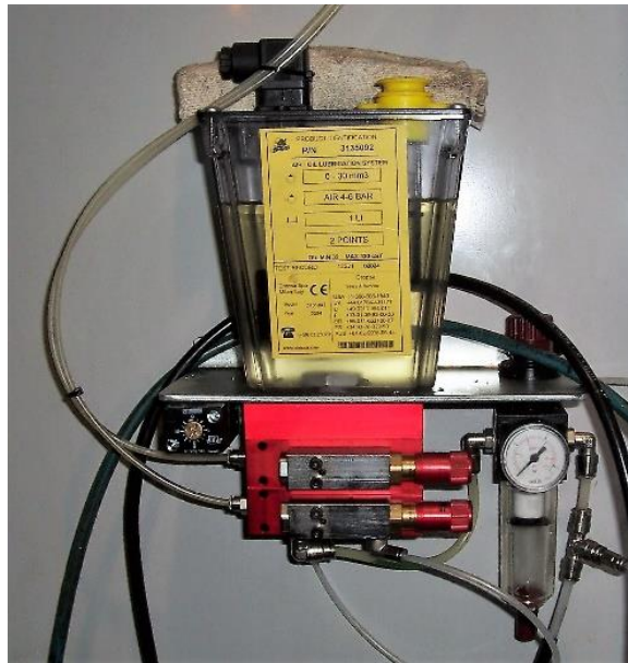
Figura 4.33. Dispositivo de inyección de aire y microlubricación.
