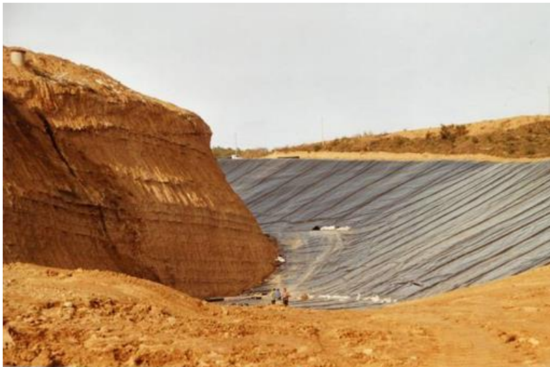
Figura 3-6.- Fase de construcción de la ampliación del Vertedero de Can Mata, correspondiente a la Celda 1 (2002)
