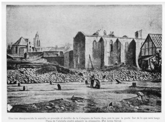
Una vez desaparecida la muralla se procede al derribo de la Colegiata de Santa Ana, con lo que la parte Sur de lo que será luego Plaza de Cataluña pudo adquirir su alineación. (Por Jaime Serra)
