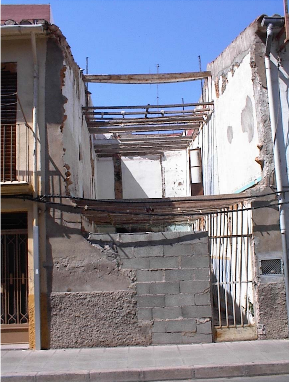
Imatge 11: Casa al Carrer 9 de març, Castelló de la Plana. Es pot apreciar clarament l'estructura de la construcció.
