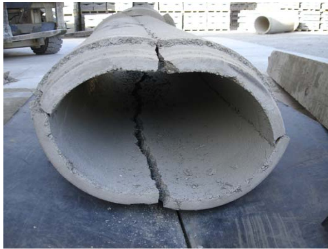
Fig. 5. Patrón de fisuración en rotura en THFA. Cortesía de PREFRAGA.
