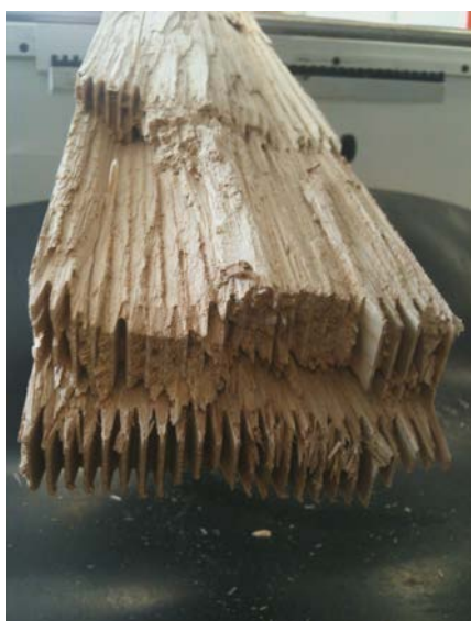
Figura 195. Unions dentades en mal estat després de la ruptura. Unions massa juntes
