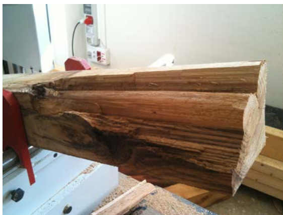
Figura 165. Biga de castanyer trencada per un cullerot
