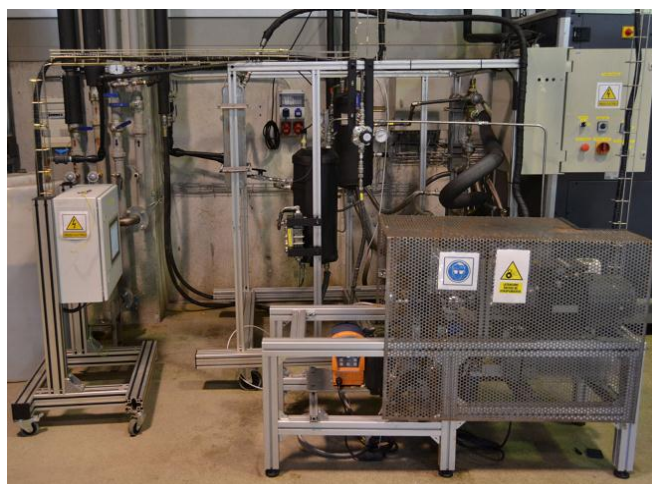
Figura 3-11. Instalación experimental para caracterizar el expansor con amoniaco.
