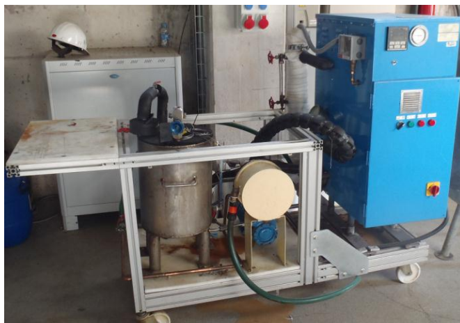
Figura 3-8. Sistema calentamiento de aire.
