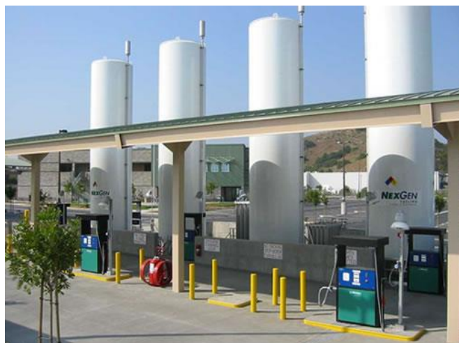
Fig. 5.4 Estación de GNL/GNC construida por Chart-NexGen en California.
