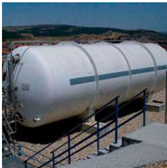
Fig. 5.3 Planta satélite de gasificación de Gas Natural Licuado en Europa.
