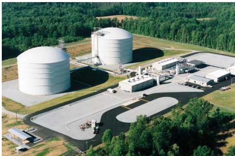
Fig. 5.2 Planta de peak-shaving en Carolina del Norte. Es una de las más grandes en Estados Unidos, con una capacidad de 0.1 billones de metros cúbicos.
