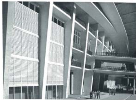
Fig. 21. — L'ensemble tribunaux, balcons et arcades des quatre rampes d'accès, entre un rampe, béton en consolidation.
