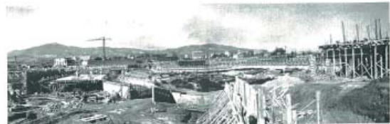
Fig. 11. — Le chantier, six mois après le début des travaux. Les gradins inférieurs sont en partie posés. Au premier plan, on voit le tunnel d'accès des joueurs. L'équipement du chantier comprend deux grues-tours, situées sur rails, de 30 et 35 m de hauteur et de 30 m de portée, ainsi que six piles, de 3 m de portée.
