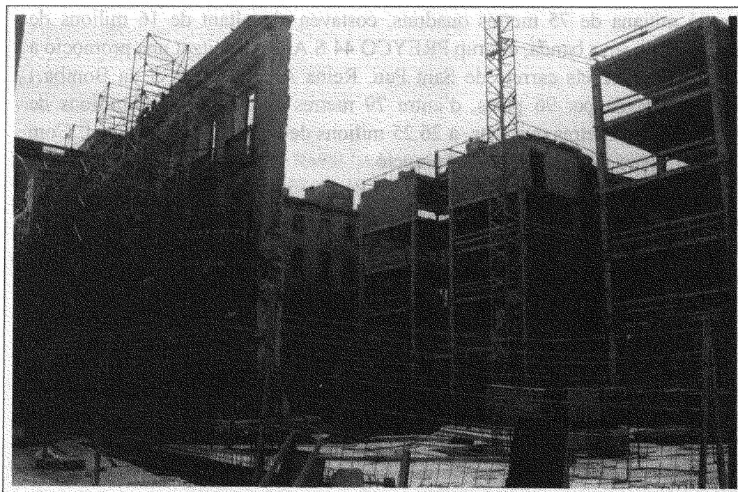
A la imatge de dalt, el projecte de construcció d'habitatges de la immobiliària PREYCO al carrer de Sant Pau (PREYCO, 1998). A la imatge de baix, estat de les obres el juny de 1999. La façana, d'una antiga fàbrica, s'ha mantingut parcialment (Sergi Martínez).
