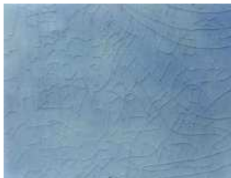
Figura 2.38 Defecto de cuarteo
