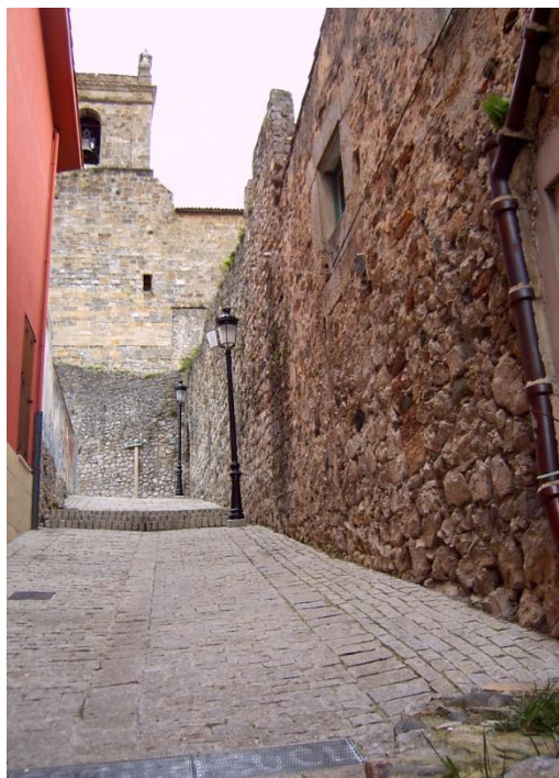
Fotografía 4: Puebla Vieja: muralla, lienzo Norte, exterior. El lienzo se ve interrumpido al fondo por la iglesia de Santa María.
