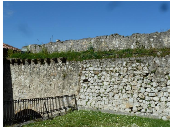
Fotografía 2: Puebla Vieja: muralla, lienzo Oeste interior. Por encima de la puerta de Santa María, se aprecian restos del paso de ronda
