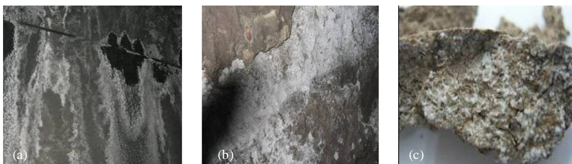
Figura 1.2 Fotografías del túnel Chengdu–Kunming con detalle en la (a) junta de dos secciones, (b) desprendimiento de sección y (c) pieza desprendida (modificado de : [5])
