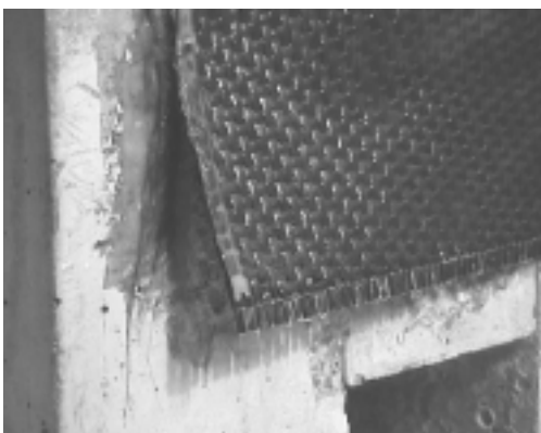
Fig. B69 Esta foto muestra en el lado "A" como se desprendió la lámina inicialmente por la parte inferior. Debe mencionarse que para poder colocar la galga al tejido transversal fue necesario adherir la lámina al hormigón por el reverso, ya que la otra cara del tejido no muestra las fibras transversales.
