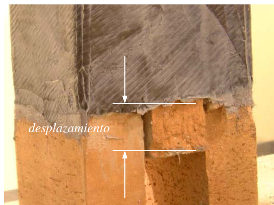
Figura 5.23 — Desprendimiento superficial y desplazamiento de la pieza central en los conjuntos WZ45 y WZ45d .
