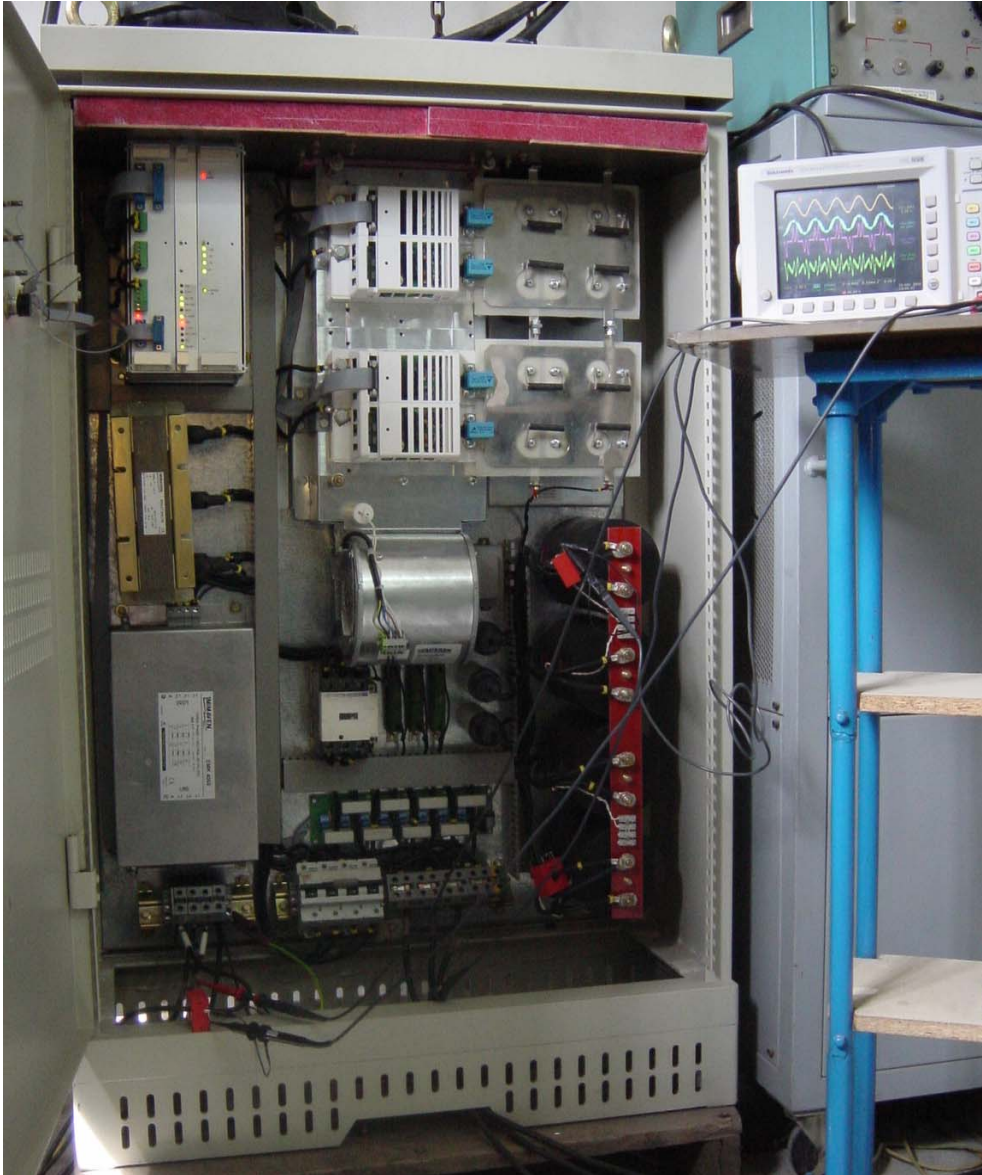
Fig. 11.10. Aspecto constructivo del FAP de 40 kVA en proceso de pruebas
