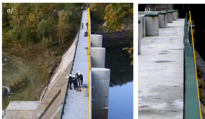
Figura 5.2 - Movimiento de la alineación en coronación hacia aguas arriba: a) Vista superior de la coronación y b) Vista de la barandilla.
