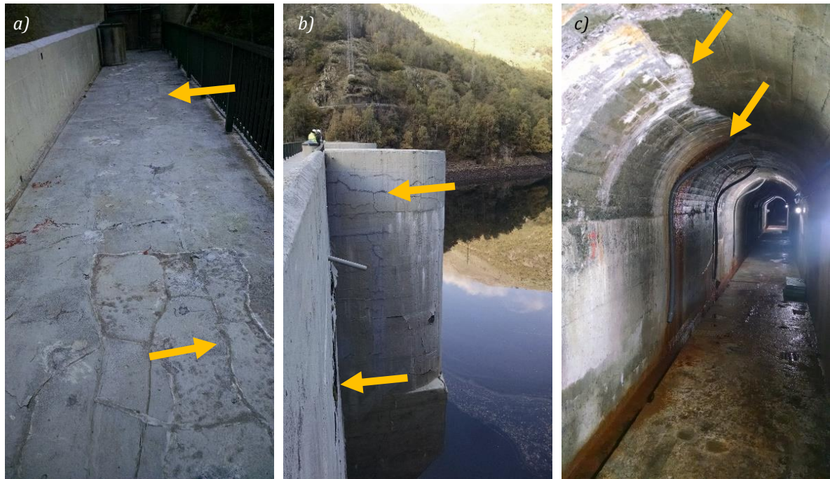
Figura 5.5 - a) Fisuras en la pasarela, b) Despegue de material en el paramento y fisuras en el tajamar y c) Coloración ocre y material blanco en la galería.
