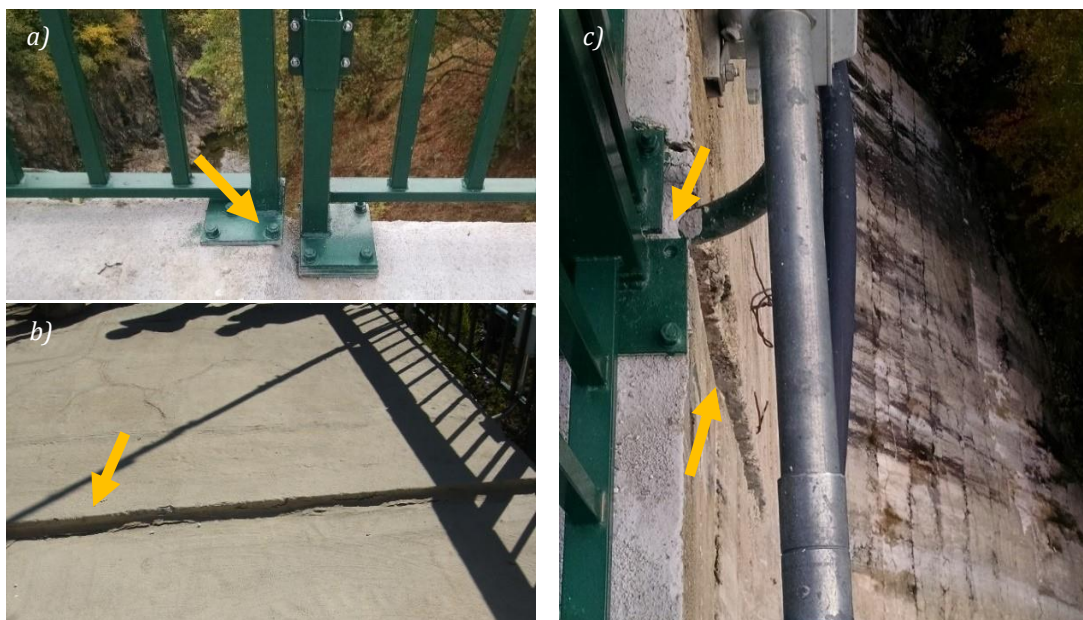
Figura 6.2 - Evidencias de desplazamientos relativos entre bloques: a) Elevación de la barandilla, b) Elevación de uno de los bloques y c) Desplazamiento horizontal entre bloques.
