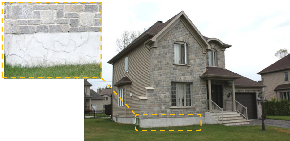
Figura 2.6 - Fisuras en la cimentación de conjuntos habitacionales (Rodrigues et al., 2012).
