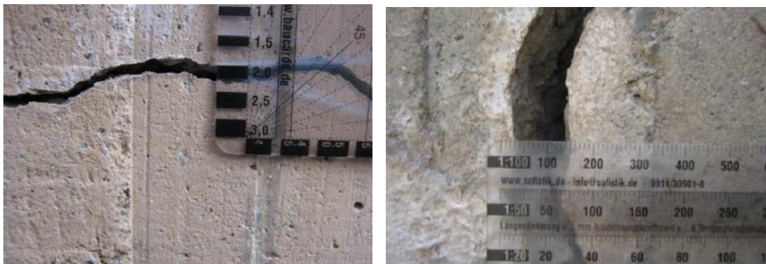
Figura 5.4 - Fisuras con apertura de más de 1,5 mm.
