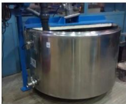
Figura 3.2 Tanc frigorífic Hackman Wedholms utilitzat com a dipòsit acumulador.
