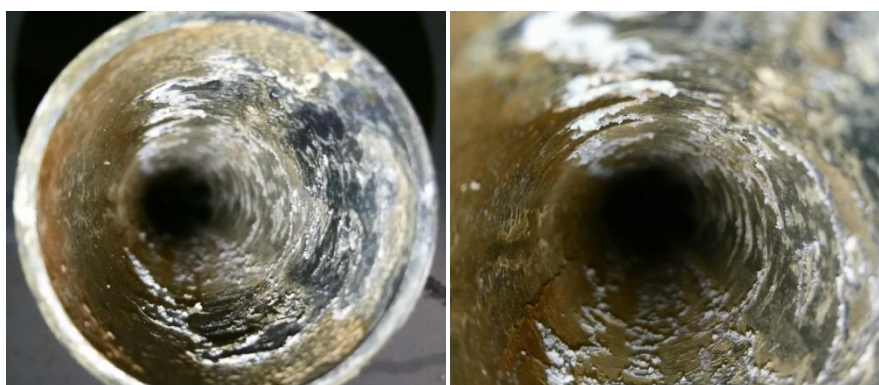
Figura 3.57 Vistes de l'interior de la canonada de diàmetre superior des del Dipòsit 1. S'hi pot observar la formació de cristalls de sal a les parets del tub.
