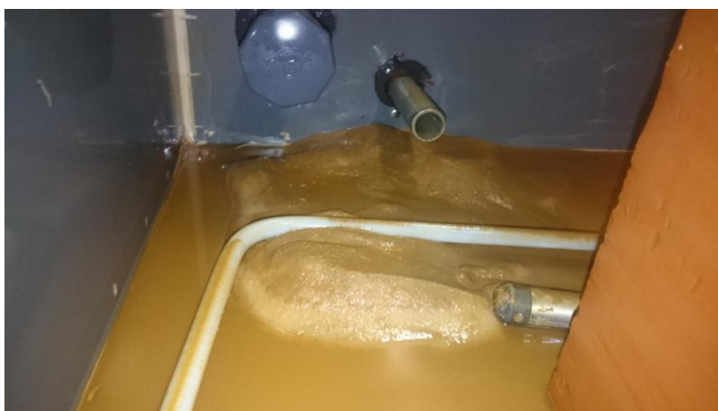
Figura 3.67 Acumulació de sediments a l'interior del Dipòsit 1, en la zona més propera a la connexió del dipòsit amb les canonades. Imatge posterior als assajos duts a terme amb la mescla S1.
