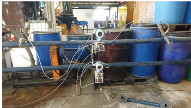
Figura 4.7 Vista del sensor de pressió diferencial (tub superior). Al centre, la pantalla de visualització de l'aparell, que es troba connectat mitjançant dos tubs als dos punts del circuit que delimiten el tram de control. La connexió amb aquests punts inclou una vàlvula d'escapament per permetre l'eliminació de l'aire atrapat.
