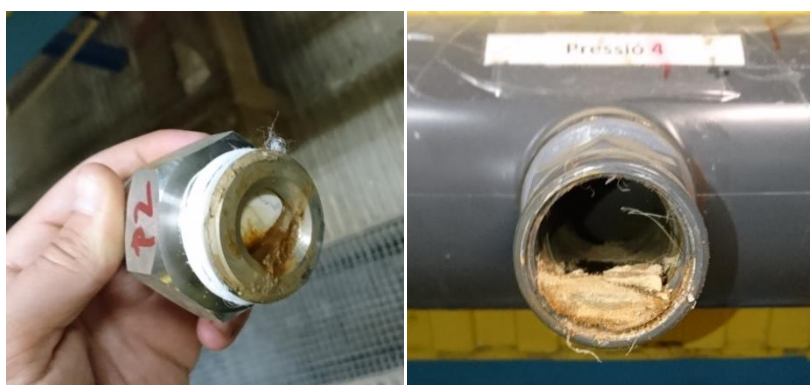
Figura 3.9 A l'esquerra, sensor de pressió amb restes de sediments acumulats. A la dreta, tub de connexió del sensor amb el circuit, també amb presència de partícules sòlides. Aquests sediments formen part de la mostra analitzada.
