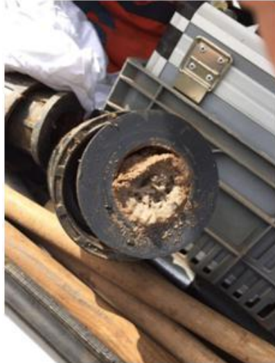
Figura 1.5 Sediments acumulats a l'interior d'una de les ventoses instal·lades a la canonada, en el Col·lector de Salmorres.
