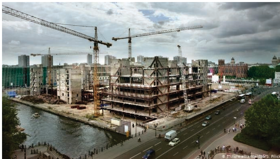
Toma aérea desmontaje de Palast der Republik, Foto: DW/S.Plick. Fecha desconocida entre 2006 y 2009.
