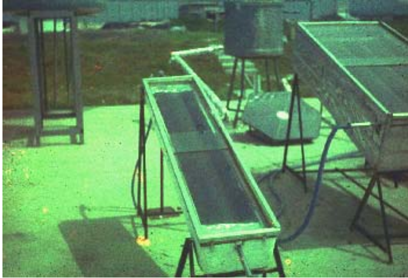
Fig. 1.8. Colectores solares en el polígono de ensayo.
