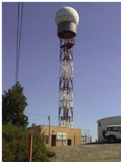
Fig. A1-4. Imatge de la instal·lació del radar meteorològic de Vallirana (Foto: J.Bech).
