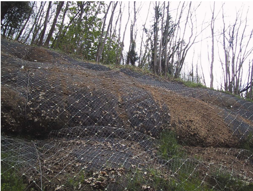
Figura 75.- Talud de suelo reforzado con una red de cables anclada. Rotura típica.
