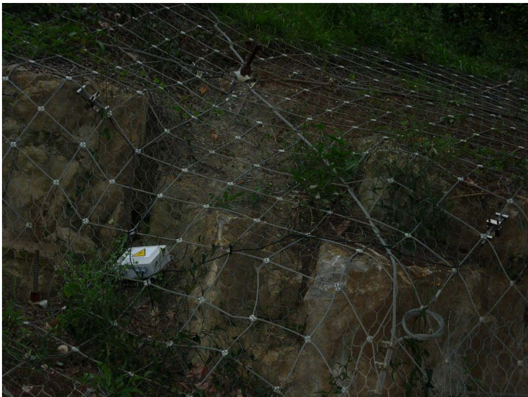
Figura 38.- Cuarta zona de medición. Tres sensores, 2 en el cable de 8 mm y 1 sensor en el de 16 mm. Zona inclinada del talud.
