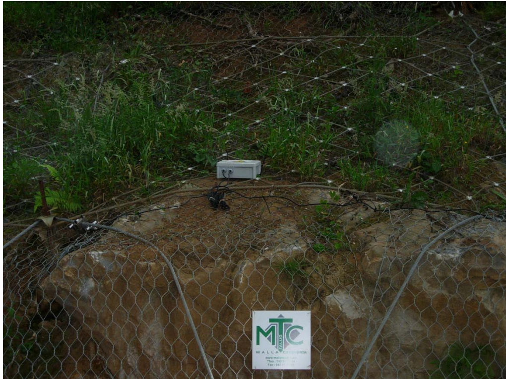
Figura 37.- Tercera zona de medición. Dos sensores en el cable de 16 mm. Equis de la zona vertical, próximos a los bulones.
