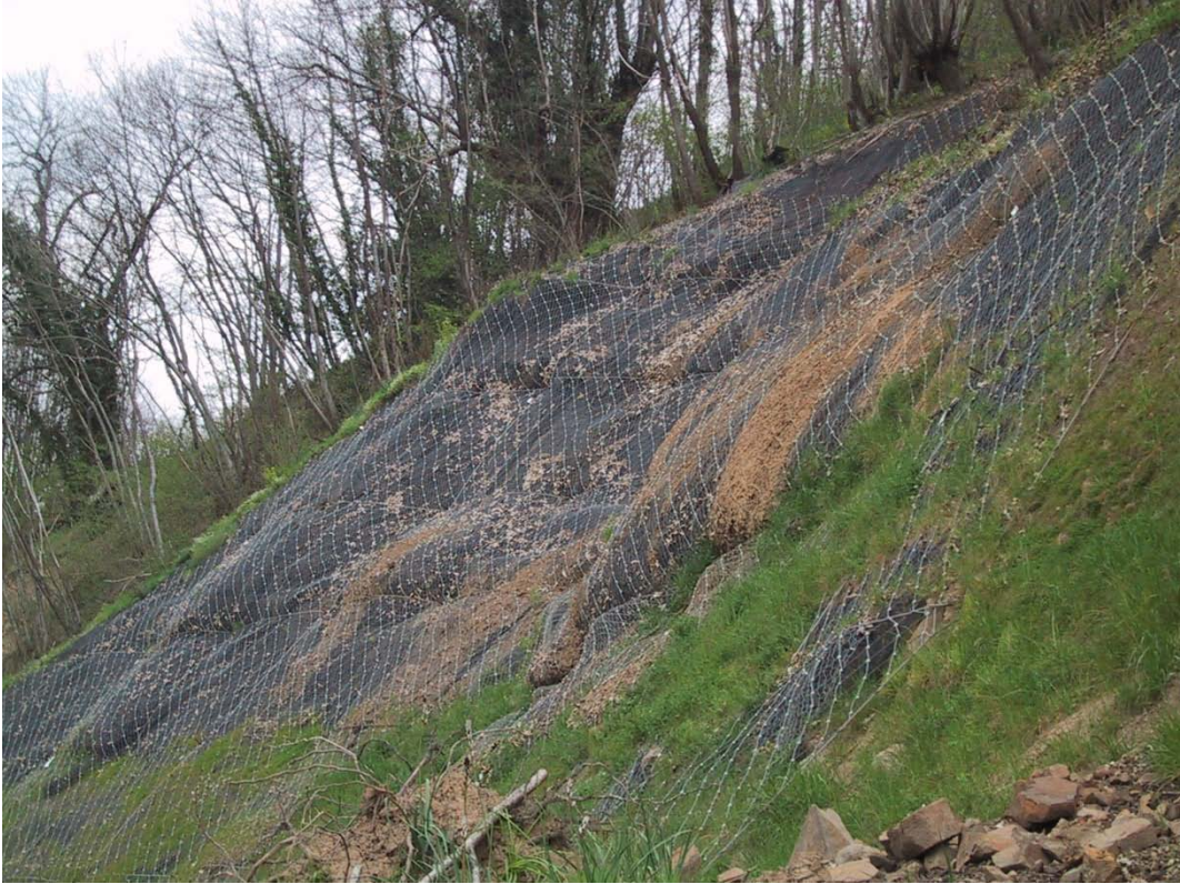
Figura 2.- Membrana flexible anclada al terreno. Ejemplo de red de cables en un talud de suelo.
