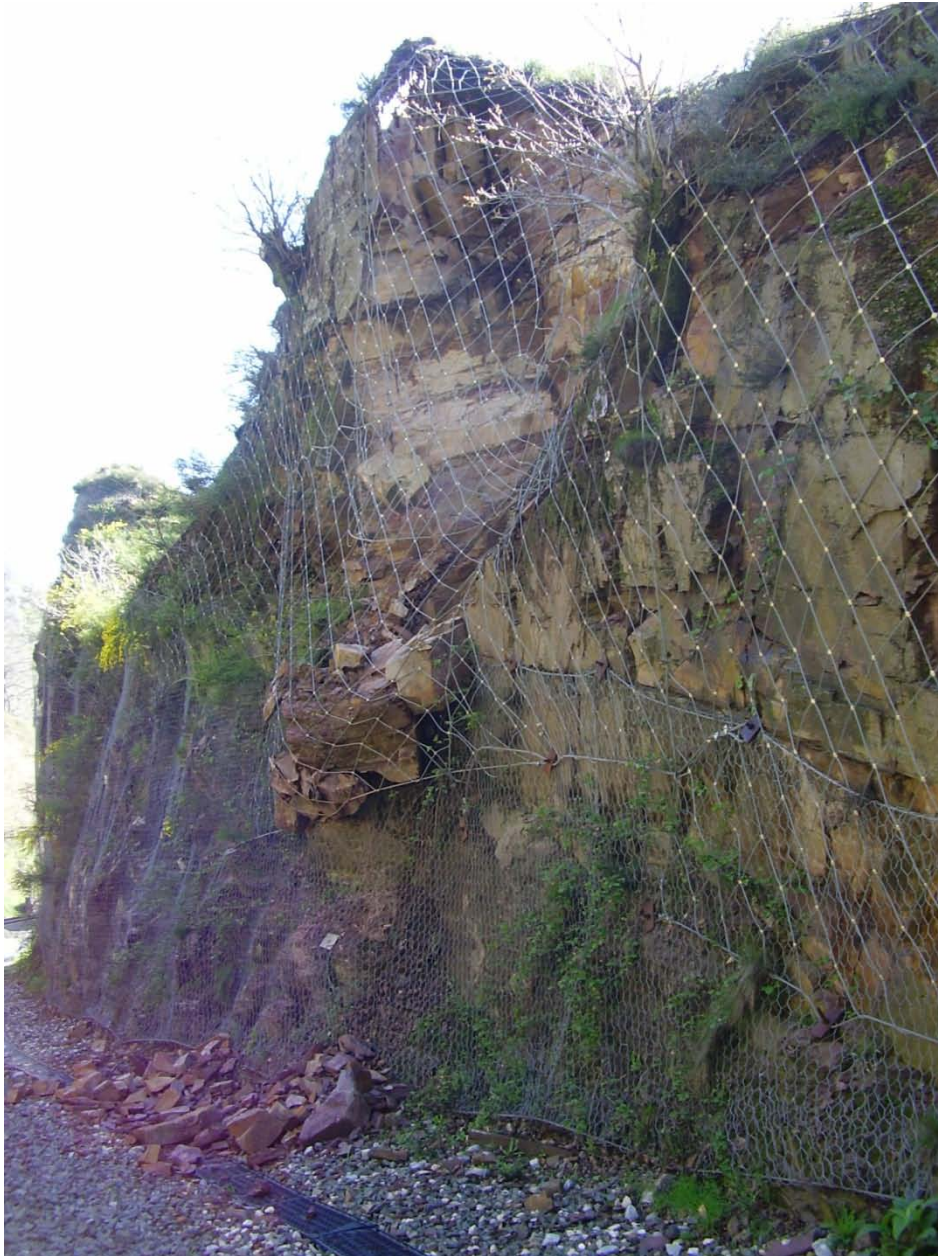
Figura 1.- Membrana flexible anclada al terreno. Ejemplo de red de cables en un talud de roca.
