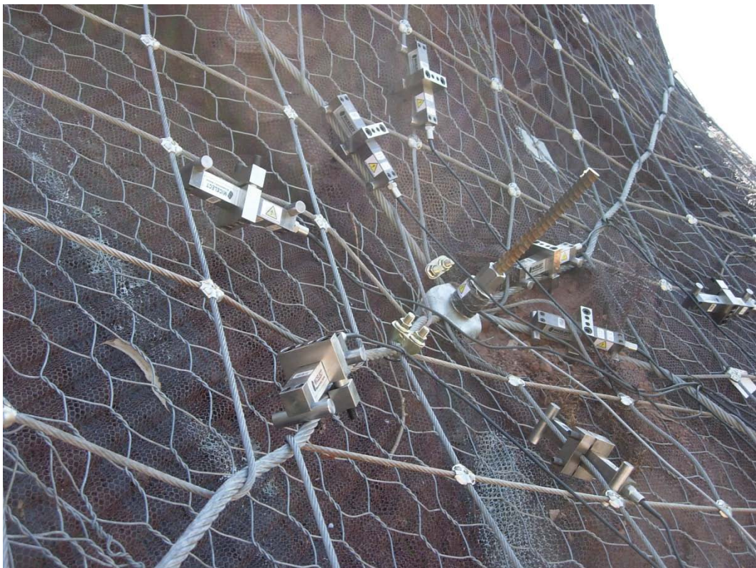
Figura 40.- Primera zona de medición. Vista en detalle.
